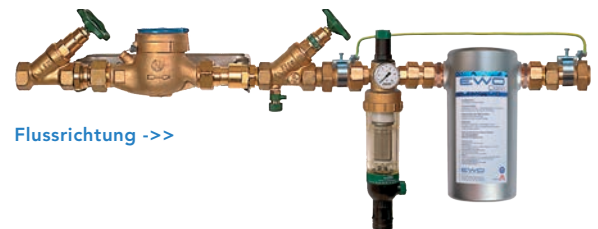
Installation beim Hauswassereingang mit Vorfilter
