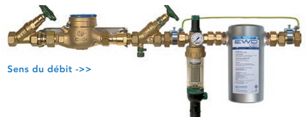
Installation sur l'arrivée d'eau de la maison avec des filtres en amont
